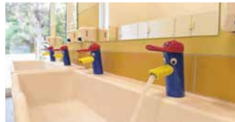
Liebe zum Detail: Diese originell gestalteten Wasserhähne gibt es im Sanitärbereich des Kindergartens.
