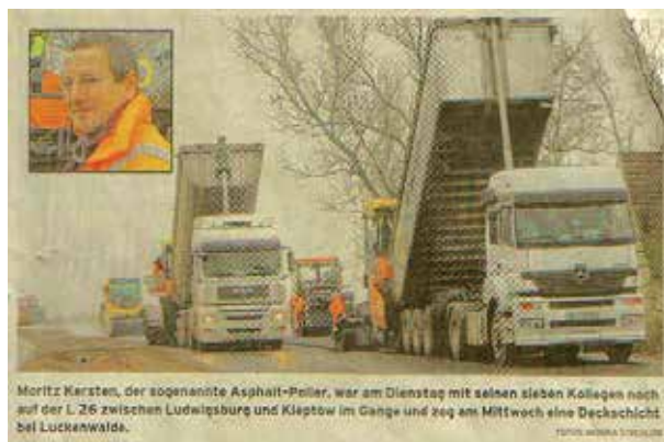
Abb. (420) Bildtext: Moritz Kersten, der sogenannte Asphalt-Poller, war Dienstag mit seinen sieben Kollegen noch auf der L26 zwischen Ludwigsburg und Kleptow im Gange und zog am Mittwoch eine Deckschicht bei Luckenwalde.
