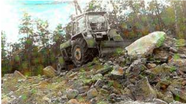
Abb. (245) Achim Döbler beim planieren der Schutt und Erdmassen mit dem ZT Traktor
